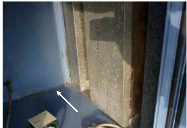
Abb. 6: Verschmutzter Bereich nach Schalldämpfer
