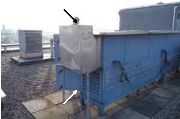
Abb. 3: Kleiner Abstand zwischen AUL-Fassung (weisser Pfeil) und FOL-Durchlass (schwarzer Pfeil)
