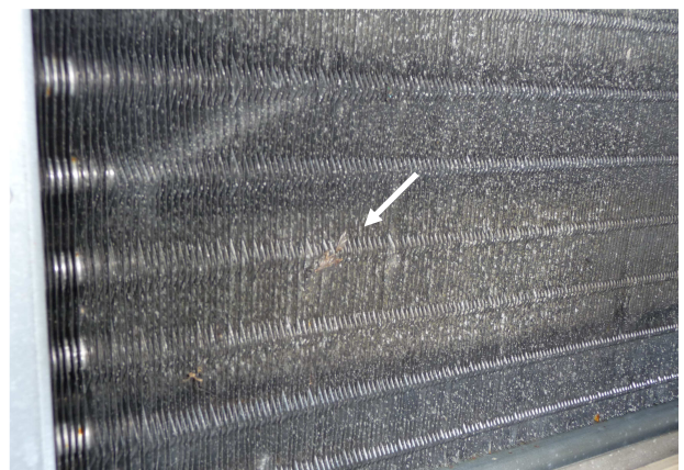
Abb. 8: Insekten auf den Lamellen des Luftkühlers
