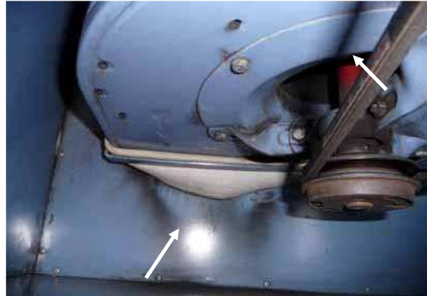
Abb. 10: Schwarze Spuren zeigen, dass der Segeltuchstützen nicht angeschlossen ist
