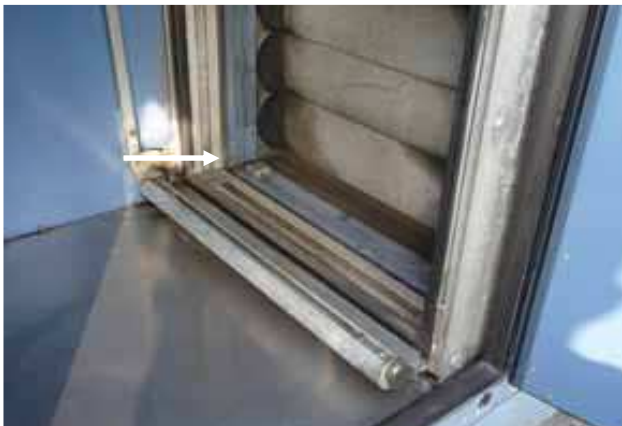
Abb. 5: Verunreinigungen im Bereich Jalousieklappen und Filterstufe
