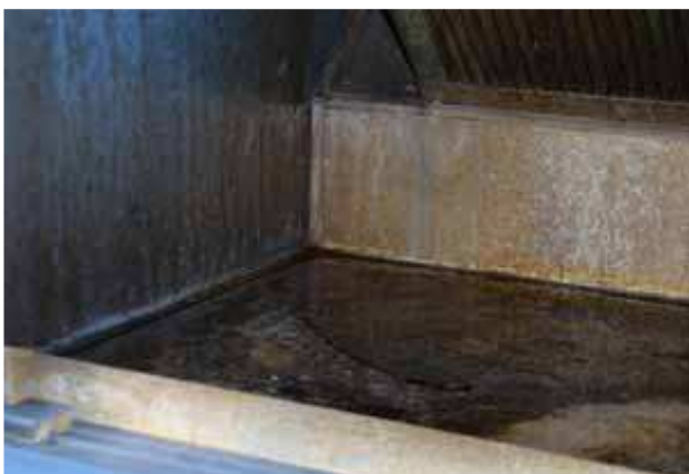
Abb. 7: Starke Verschmutzung auf der Abluftseite des Kreuzstromwärmetauschers
