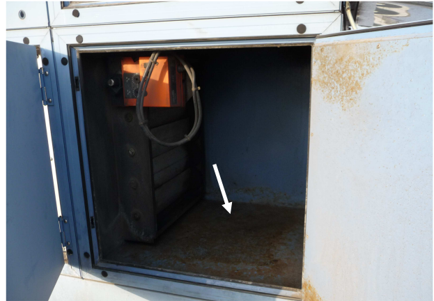
Abb. 4: Übermässige Korrosion im Anschluss an die Ausenluftfassung
